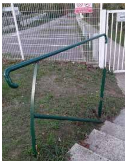
Dégradation de la barrière école du Bois de Chênes
